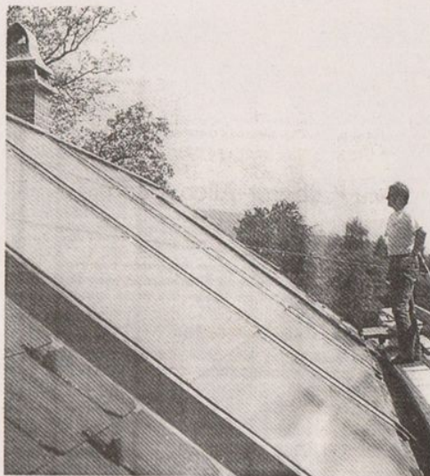
Die Sonnenkollektoranlage auf dem Dach des Hauses von Markus Aepli konnte besichtigt werden.
