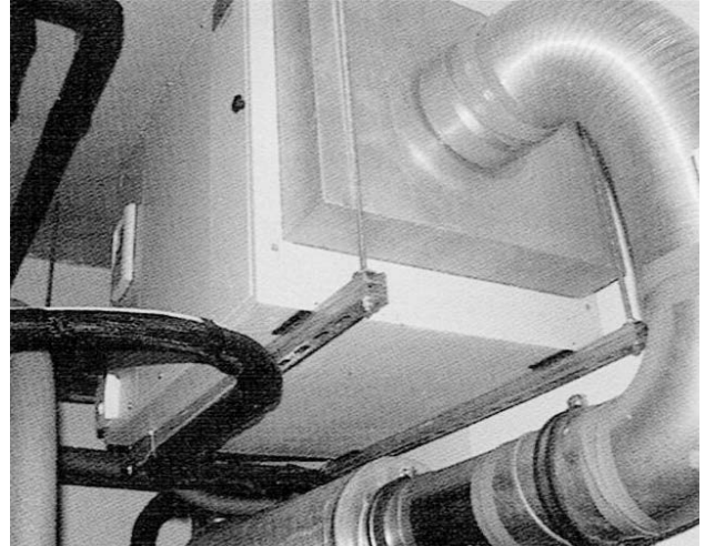
25–30 % der thermischen Energie wird über die Abluftwärmepumpe bereitgestellt.
