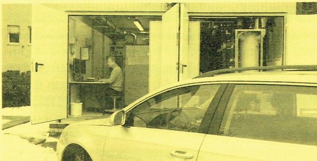
Die Pionieranlage von ZSW und der Solarfuel GmbH: Im linken Container wird mit einem Elektrolyseur Wasserstoff und nach Zugabe von CO 2 Methan (E-Gas) hergestellt. Rechts wird das zur Methanherstellung nötige CO 2 per Absorptionsanlage aus der Luft gewonnen.
